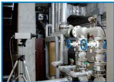
排管等设施的振动测定
